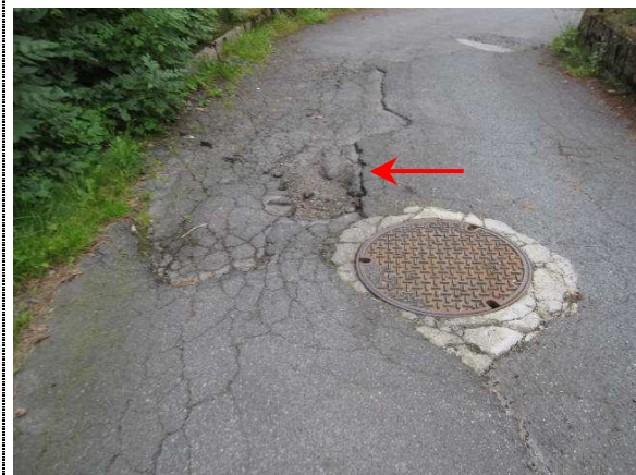
Bilde nr. 3 - Stikkveiene rundt bygningene er dårlig vedlikeholdt. Asfalten har sprekker og ujevnheter.
