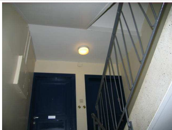
Bilde nr. 27 - Innfelte sikringskap og kompaktlyskilde i tak.
