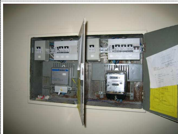
Bilde nr. 31 - Sikringskap med nyere innmat og automatsikringer fra 1990-tallet.
