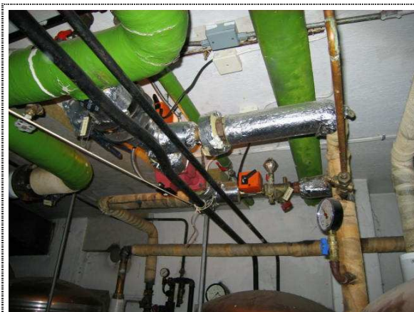
Bilde nr. 42 - Røranlegget i fyrrom.
