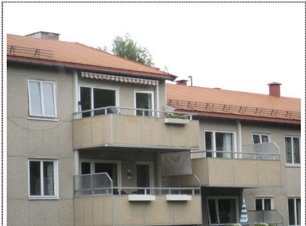
Bilde nr. 2 - Taktekingen består av stålplater. Balkongene ble rehabilitert på tidlig 1980-tallet.
