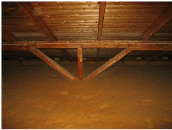
Bilde nr. 35 - Undertakene virker tørre og fine og det er ikke opplyst om lekkasjer fra takene.
