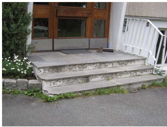
Bilde nr. 11 - Betongtrapper er belagt med skifer. Enkelte er ødelagte blant annet pga. påkjørsel og lignende. Trappen bør males (opptrinn) og rekkverkene oppgraderes.
