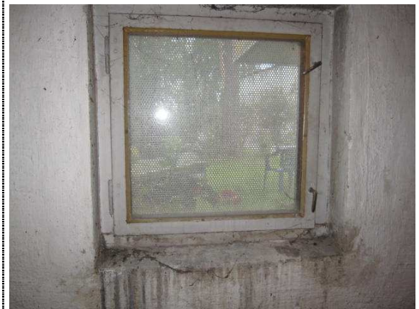
Bilde nr. 16 - Kjellervinduene har behov for rengjøring og maling.
