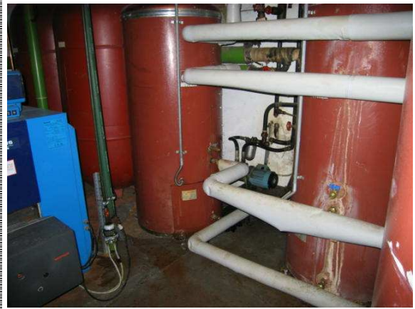
Bilde nr. 36 - Varmtvannsbereidere er fra 1983 og har stått ut over forventet levetid. Byttes.
