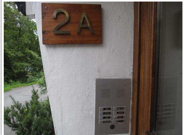
Bilde nr. 26 - Porttelefonanlegget er fra 1990-tallet.
