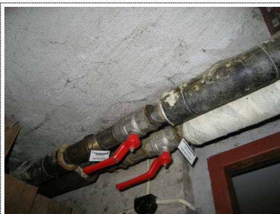
Bilde nr. 30 - Hovedføringer for kaldt- og varmtvannsrør har nye stengeventiler.
