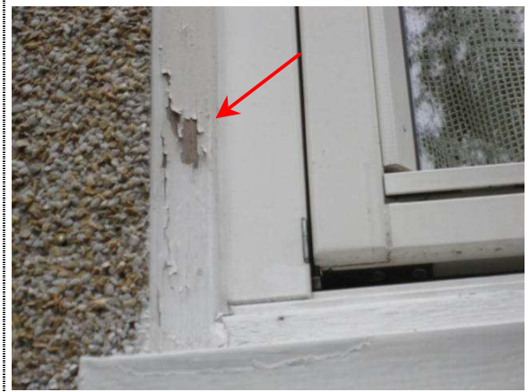
Bilde nr. 12 - Bygningene har i all hovedsak vinduer fra 1986. Det er beboers eget ansvar å skifte vinduene, men vedlikeholdet er boligsameiets ansvar. Her vises et malingslitt vindu.
