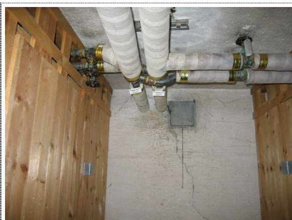
Bilde nr. 29 - Varmesystem med opprinnelige stengeventiler.
