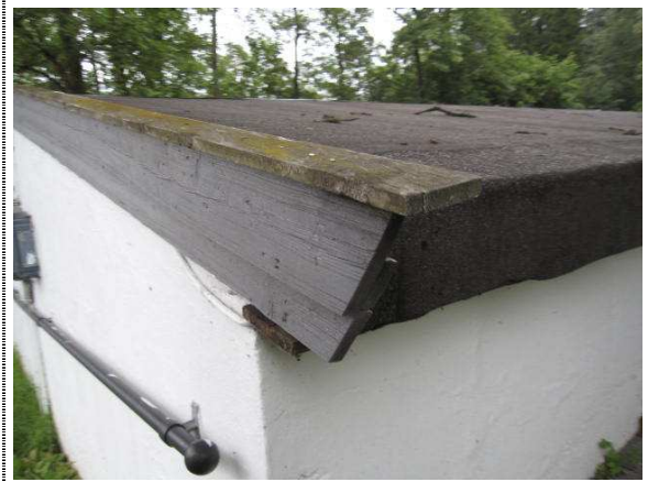
Bilde nr. 24 - Vindskier/vannbord bør byttes på garasjene.
