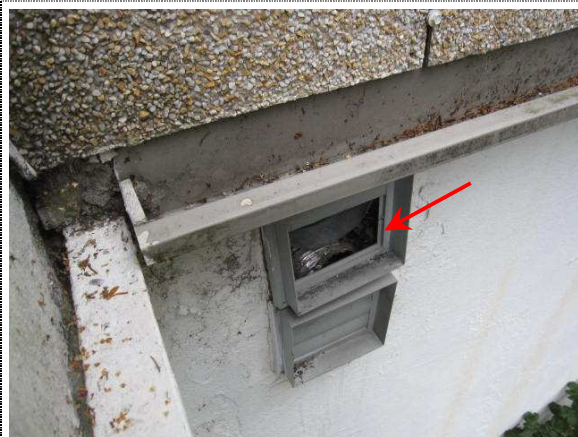
Bilde nr. 21 - Takrenner bør rengjøres jevnlig av vaktmester. Luftventil repareres.
