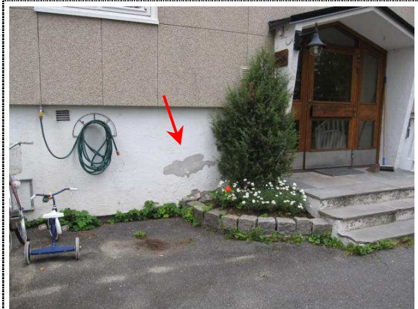
Bilde nr. 22 - Noe pussavskalling på grunnmuren i nr. 6.
