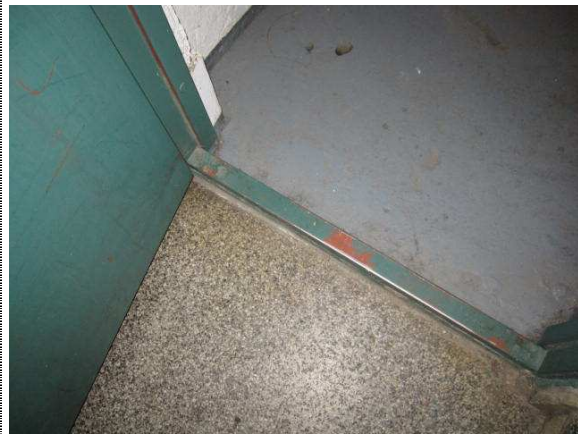
Bilde nr. 19 - Ståldørene i kjellerarealene bør slipes og males i løpet av 2-5 år.
