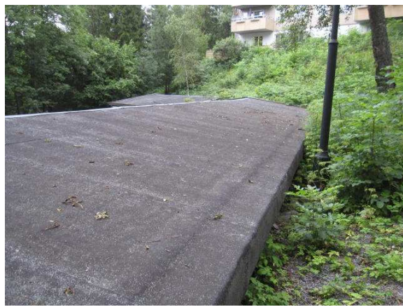
Bilde nr. 23 - Garasjene er dårlig vedlikeholdt. Busker og trær bør fjernes fra garasjebygningene. Taktekingen bør vurderes utskiftet.
