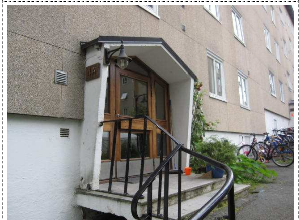
Bilde nr. 6 - Trappene ifm. inngangspartiene bør vedlikeholdes.
