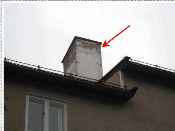
Bilde nr. 5 - Pipeløpene har behov for vedlikehold over tak.
